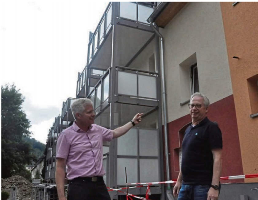
Vor den Häusern an der Breslauer Straße machten sich Woge-Chef Ingo Wöste (links) und sein Bauingenieur Markus Zanger ein Bild vom Fortgang der Sanierungsarbeiten.
